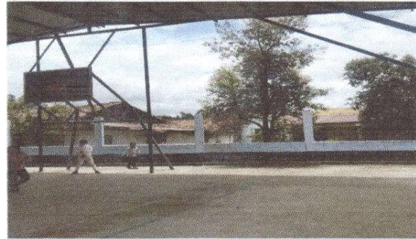
Foto:2 Esta malla se sustituirá por estar en mal estado
