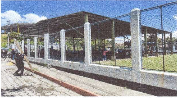
Foto: 1 La malla se cambiará porque está en mal estado
